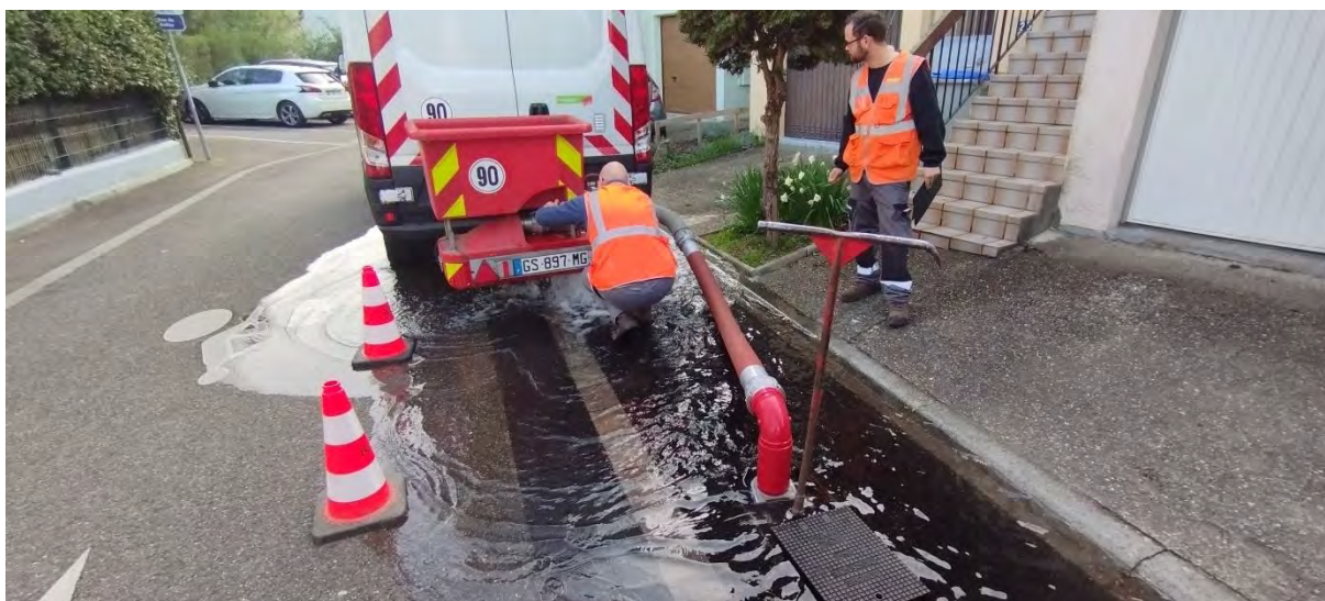
Test d'une bouche incendie
